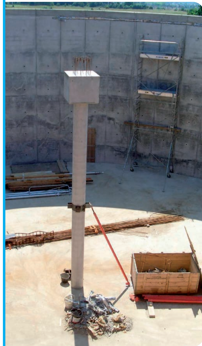
Bassin de stockage d'eau potable
