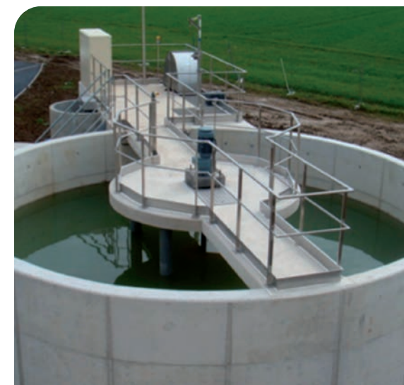
Métallerie d'une STEP
